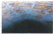
腐食した下水道管の内部
